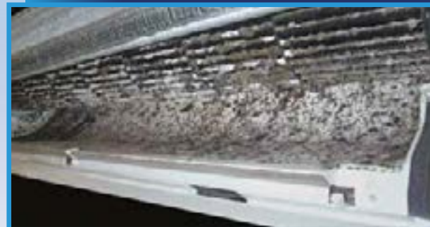
Turbina klimatyzatora naściennego porośnięta pleśnią
